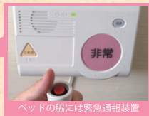
ベッドの脇には緊急通報装置
